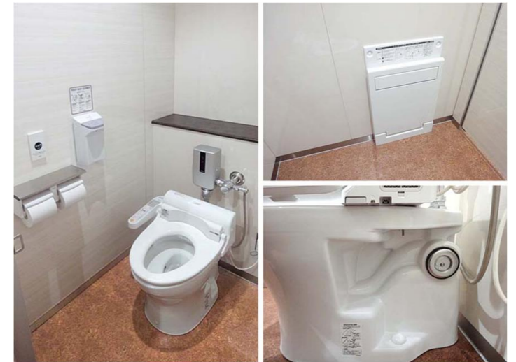
環境やメンテナンス性に配慮して、大便器は4.8L洗浄の掃除口付きパブリックコンパクト便器を採用。すべてにウォシュレットを設置し、フィッティングボードや除菌クリーナーも完備している（男女共通）。
