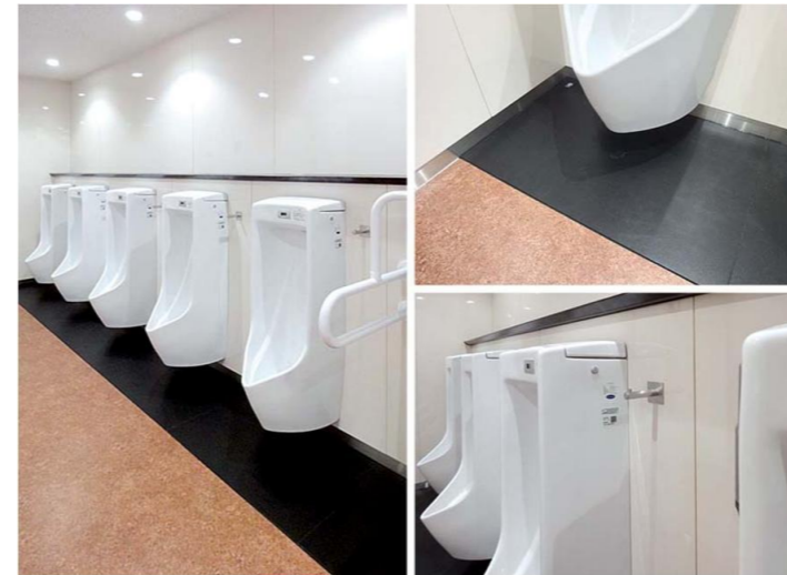
尿石の付着やにおいの発生を抑制することができる、ジアテクト機能付きの小便器を採用。足元には、尿の飛散によるにおいや汚れを軽減できるハイドロセラフロアPU（薄型）を設置している。
