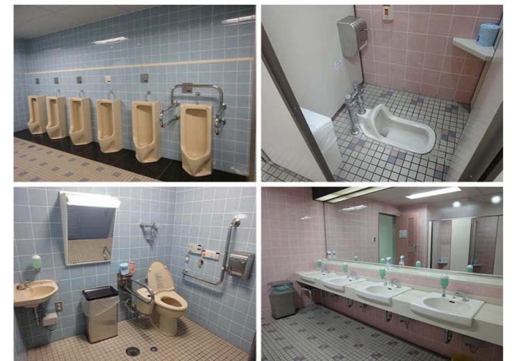
改修前のトイレは照明も薄暗く、壁・床ともタイル張りの旧態イメージの寒々しい雰囲気、リフレッシュできる空間ではなかった。
